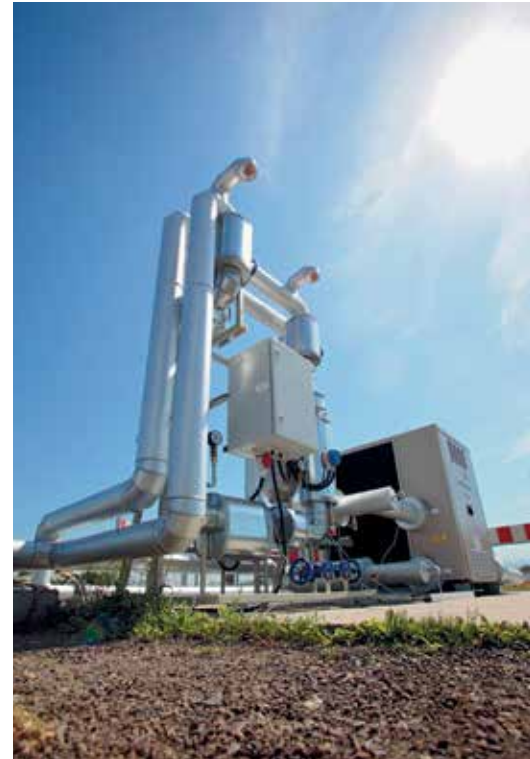
Agrokühl hat es bewiesen: Kühlräume können mit Hilfe der Sonne gekühlt werden.
